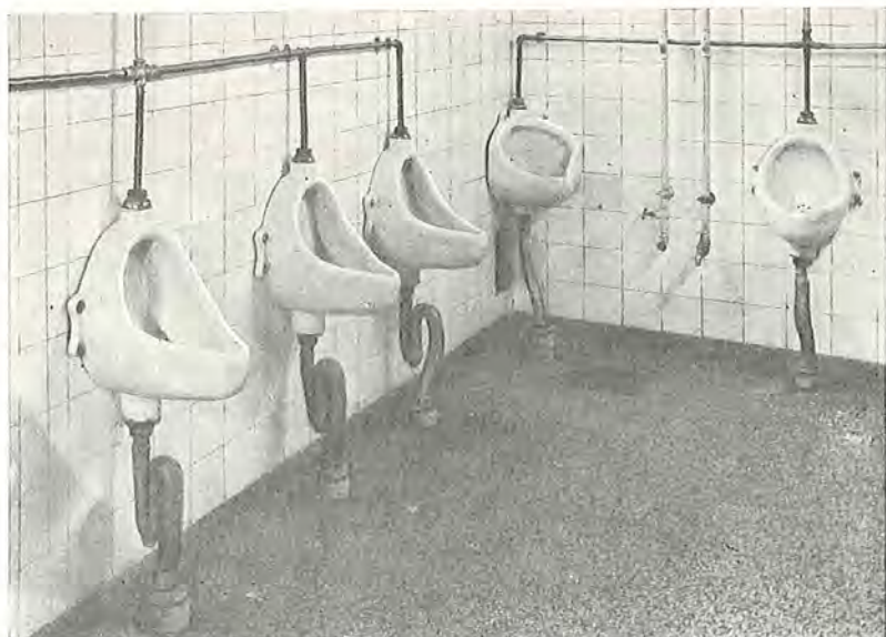
Fig. 67. Vægurinals af fajance, forsynet med blyvandlåse.
